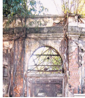
உரு 1.26 உடைந்த பாழடைந்த வீட்டுக் கட்டடம்
